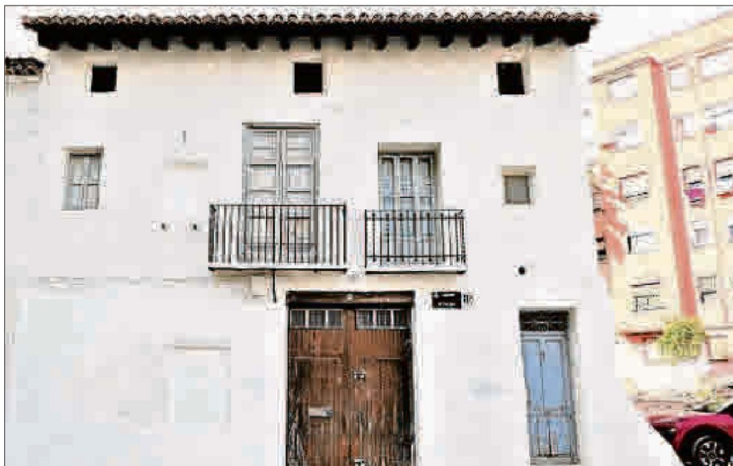
Alquería situada en el número 15 de la calle Olba, donde se aprecia el hueco tapiado del retablo. A. MARÍN SEGOVIA
