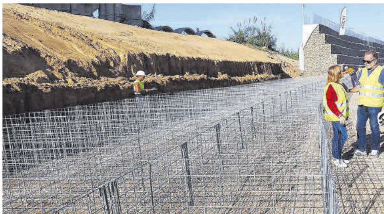
Trabajos de construcción de una mota junto al Magro a su paso por el término municipal de Alcúdia.
