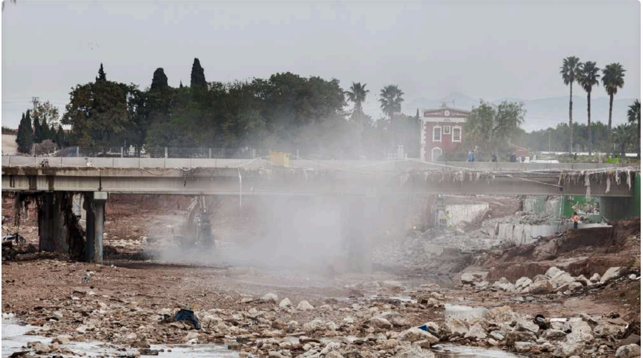
Puente Paiporta arrasado por la Dana. Foto: GVA
